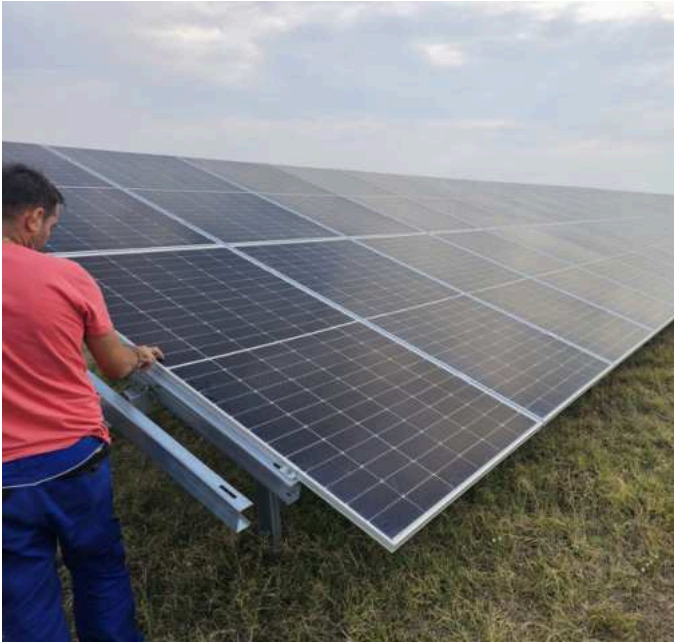
PARC FOTOVOLTAIC MIZIL
